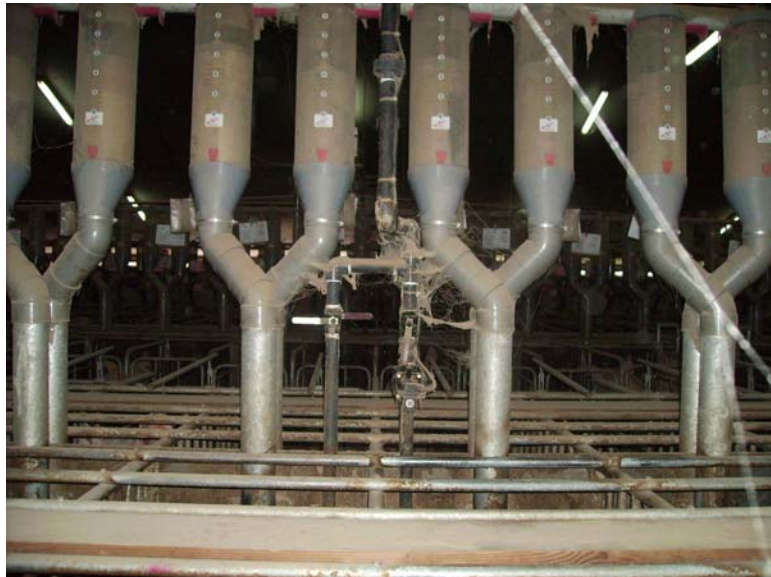
Photographie 1 : Système d'alimentation et abreuvement utilisé dans le grand bâtiment de truies gestantes (le système de jauge garantit la présence constante d'eau dans les auges)
