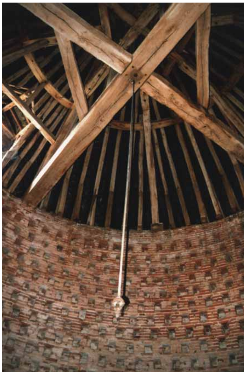
Figure 24 : Mur de boulins en briques du colombier de Bourgtheroulde Notez, sur cette vue, la trace qu'a laissé sur la poutre le frottement de l'échelle centrale.
