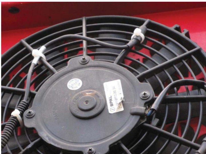
Sonde de température placée à côté d'un ventilateur latéral.
