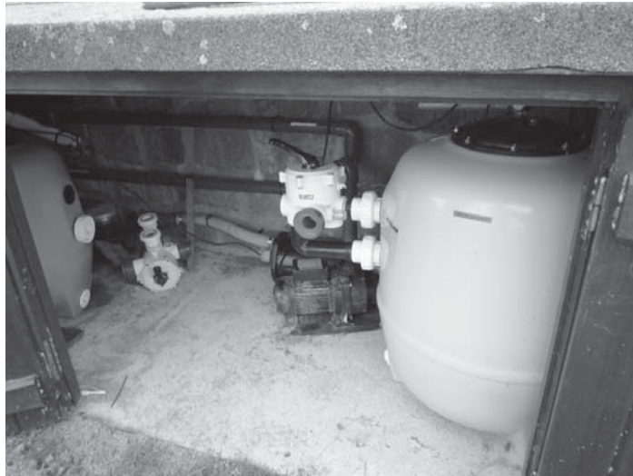
Photo 39 : Système de filtration de l'eau des piscines à la station LPO de l'île Grande
