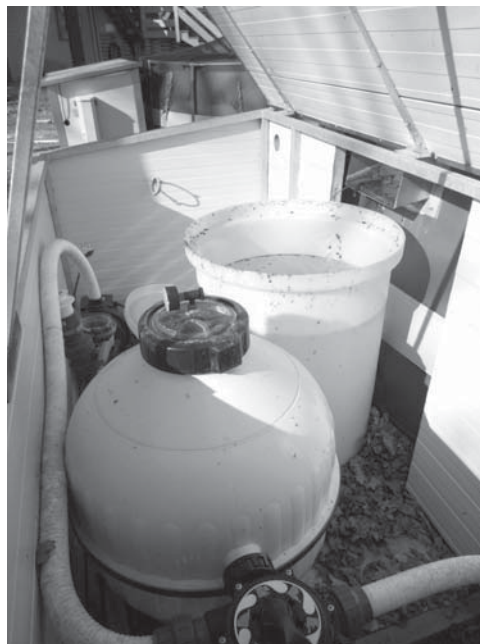
Photo 54 : Système de filtration des piscines
