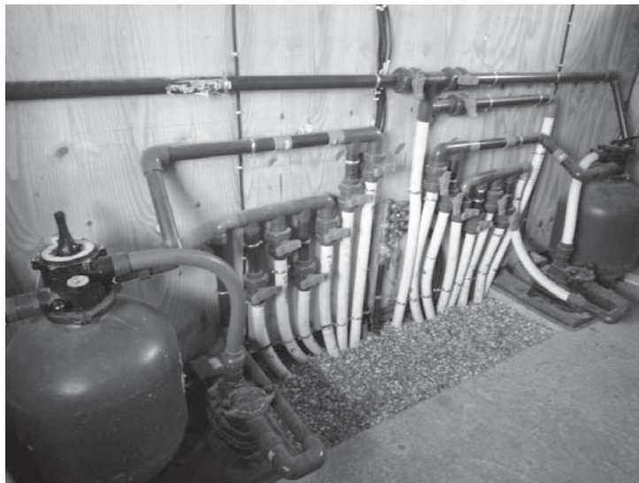
Photo 49 : Système de filtration des piscines au CHENE
