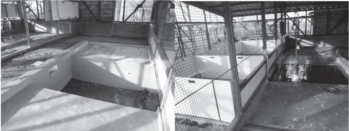
Photos 47 et 48 : Piscines au CHENE
