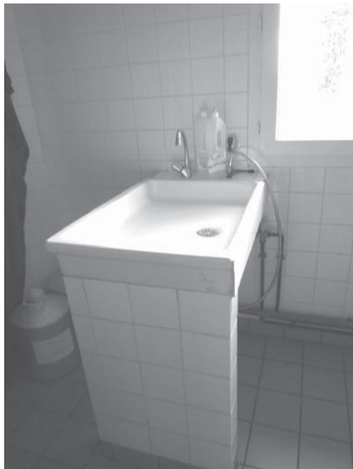
Photo 26 : Poste de nettoyage au CHENE
