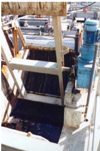
Figure 1 : Dégrilleur à grille courbe (cliché Honet)
