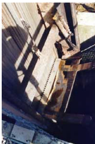
Figure 2 : Dégrilleur à grille droite à nettoyage alternatif (cliché Honet)
