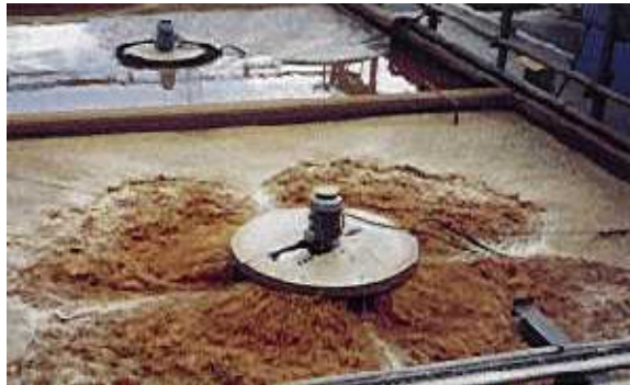
Figure 9 : Réacteur aérobique à boues activées et aération de surface (cliché Aaqua Waste Water Technology)
