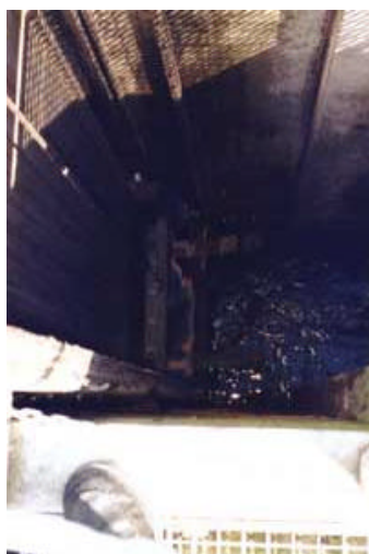
Figure 4 : Puits de relevage (cliché Honet)
