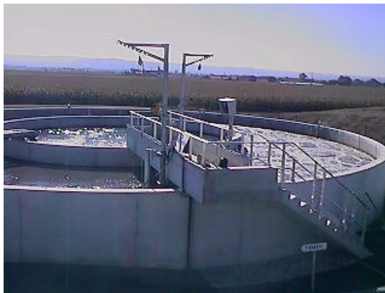
Figure 10 : Ensemble bassin d'anoxie (au centre) et bassin d'aération (cliché Rectorat de l'Académie de Grenoble)
